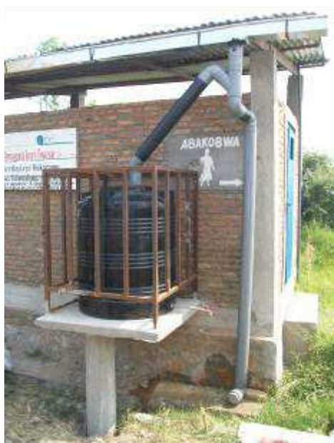
Système de récupération des eaux pluviales à l'école primaire de Rukaramu
